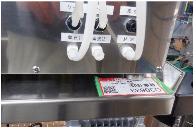
裏配管部 薬液1, 純水部テフロン配管あり
